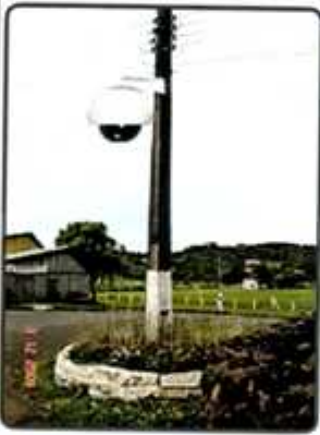
CÂMERA SPEED DOME - 01 ENTRADA - SERVIÇOS
