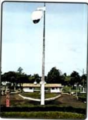
CÂMERA SPEED DOME - 05 ENTRADA PRINCIPAL
