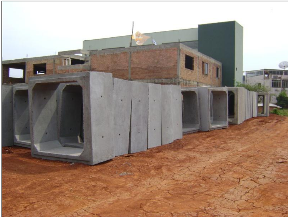
Figura 145: Obras Realizadas na Rua Irineu Bornhausen e Athanásio Antônio em 2010. Detalhes para as Tubulações Utilizadas de 3 m.
