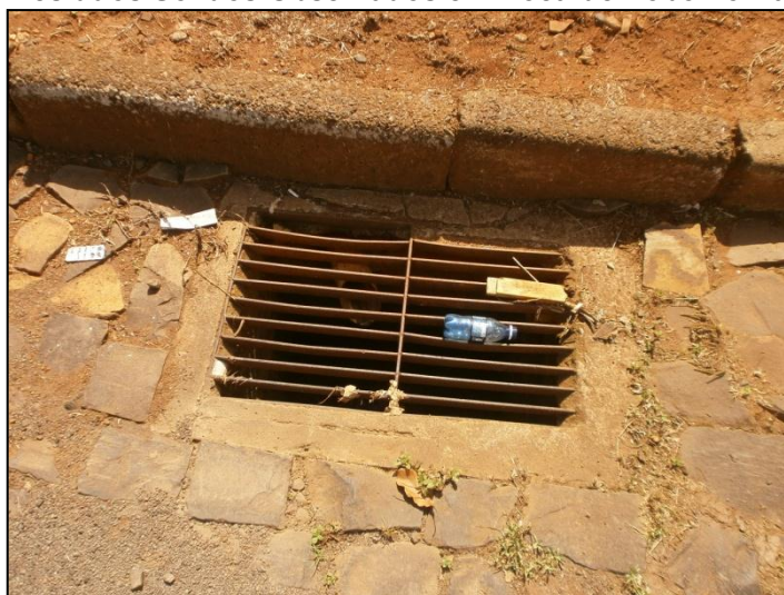
Figura 132: Resíduos Sólidos Observados em Boca-de-Lobo no Bairro Veneza.
