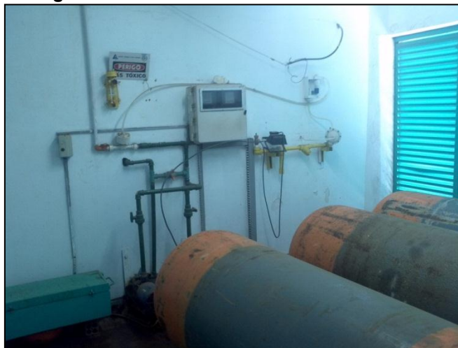
Figura 37: Cilindros e Dosador de Cloro Gás.
