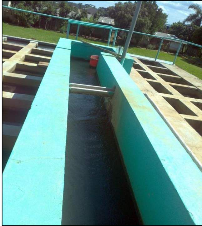
Figura 33: Canal de Chegada e Aplicação de Carvão Ativado e Cal.
