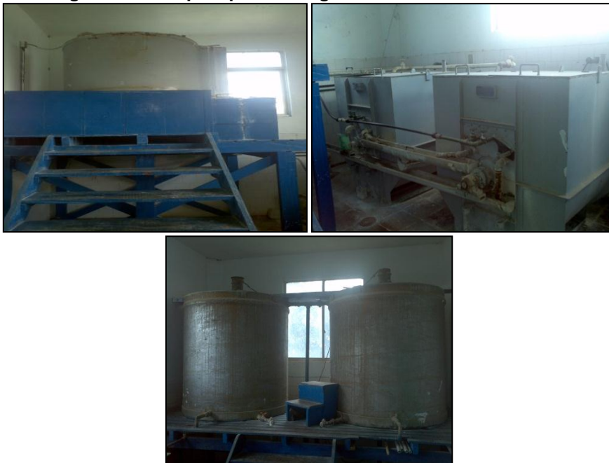
Figura 39: Tanques para Dosagem de Produtos Químicos.
