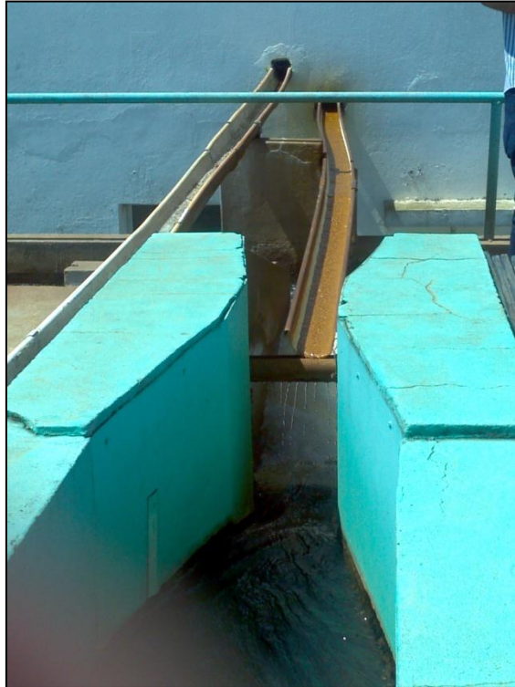
Figura 32: Calha Parshall e Aplicação do Coagulante Sulfato de Alumínio.
