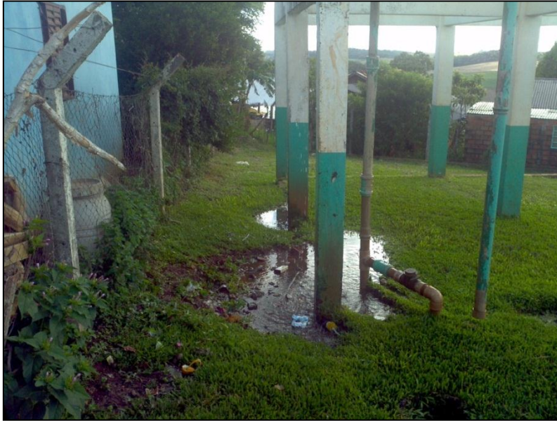
Figura 56: Vazamento Significativo - R6.
