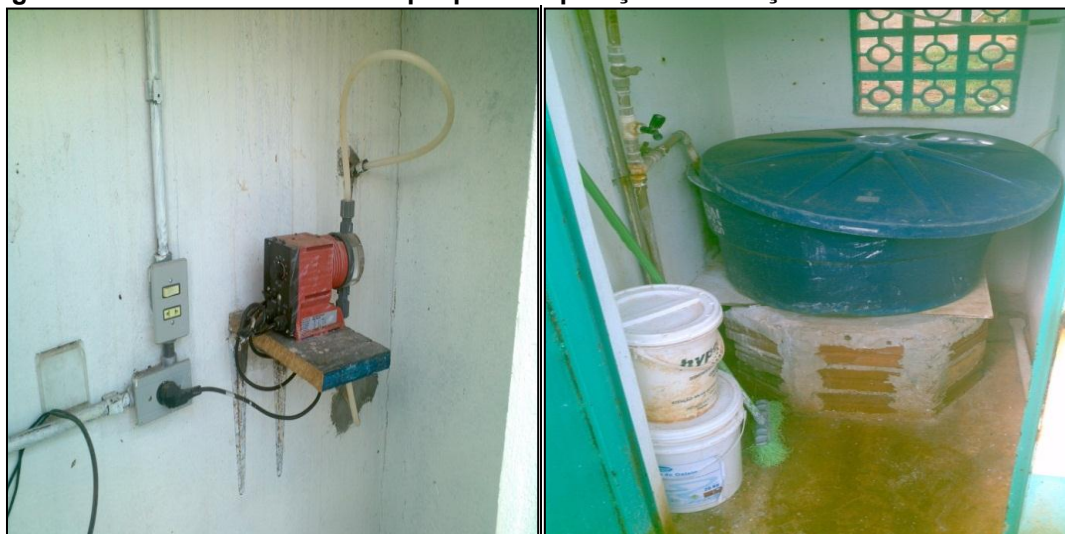
Figura 30: Bomba Dosadora Tanque para Preparação da Solução de Cloro e Flúor – P2.
