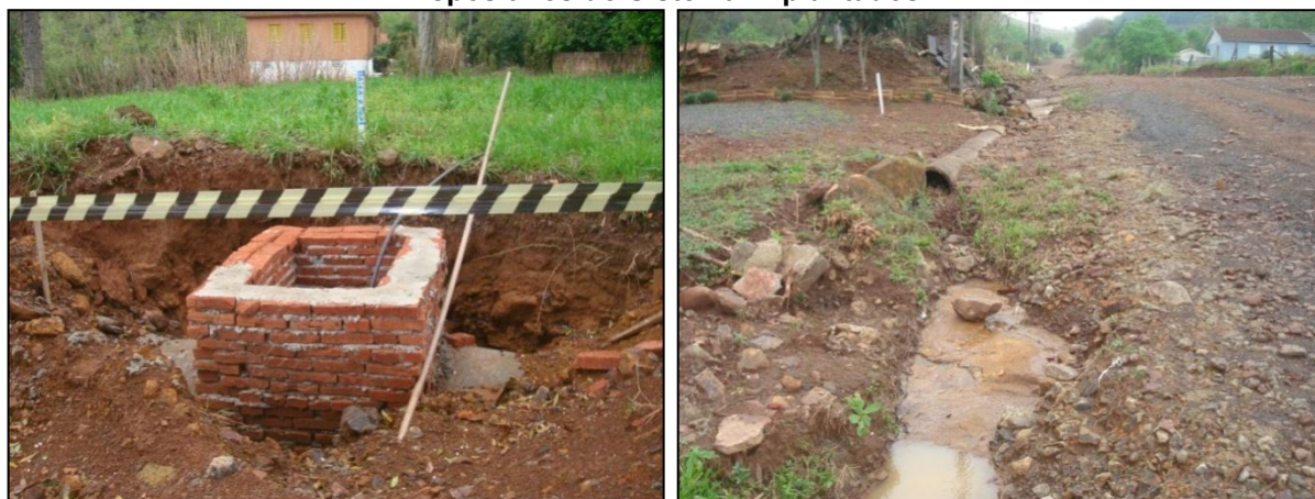
Figura 122: Pavimentação Distrito de Cambuinzal – Xanxerê, área rural. Detalhes de Dispositivos do Sistema Implantados.
