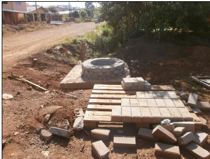
Figura 126: Pavimentação de Bairros de Xanxerê no Final de 2012. Detalhe para Execução de Poço de Visita na Via.
