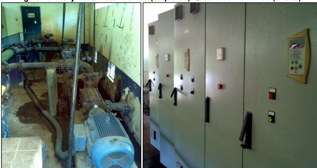
Figura 23: Conjuntos Motor Bomba (esquerda) Quadro de Comando (direita).
