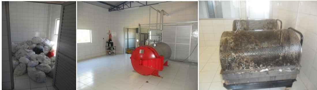
Figura 89: Local de armazenagem temporária e equipamentos da unidade de desinfecção de resíduos de saúde.
