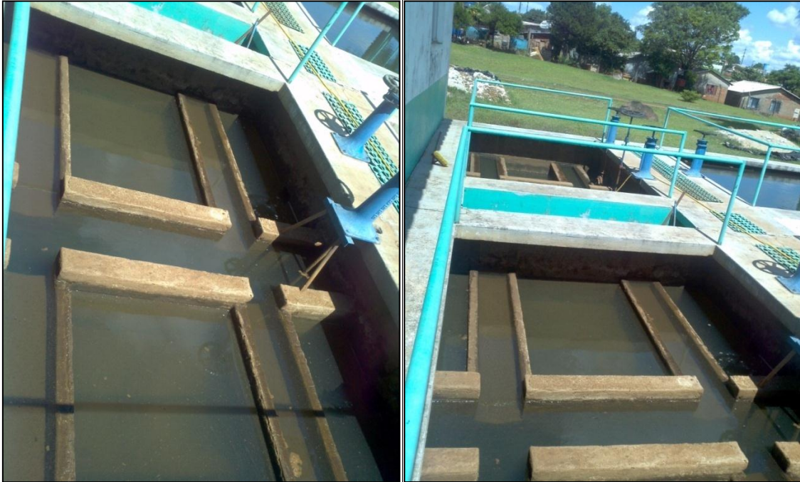
Figura 36: Filtros da ETA.
