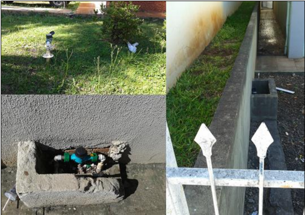
Figura 59: Hidrômetros Instalados em Xanxerê.
