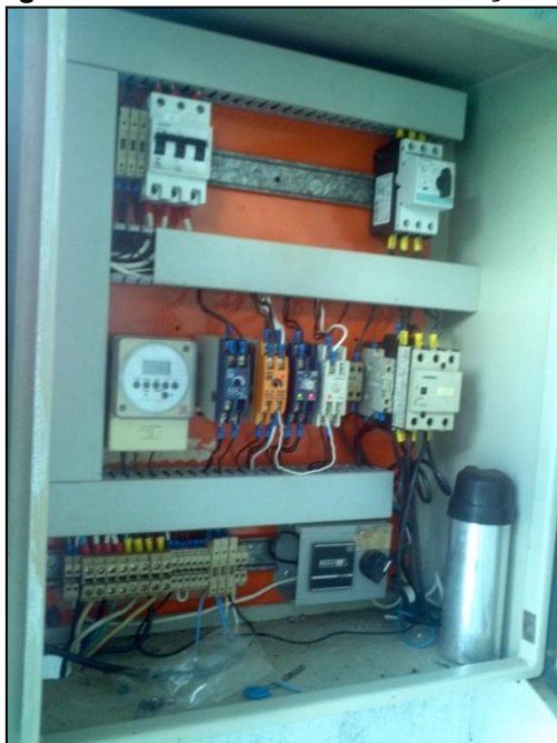
Figura 31: Painel de Comando – Poço P2.
