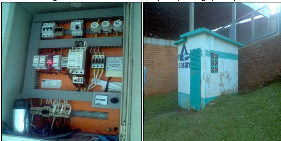
Figura 28: Painel de Comando (esquerda) e Abrigo (direita).
